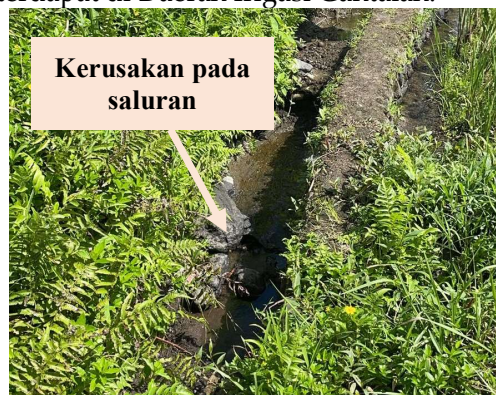
Gambar 5. Kerusakan pada saluran tersier
