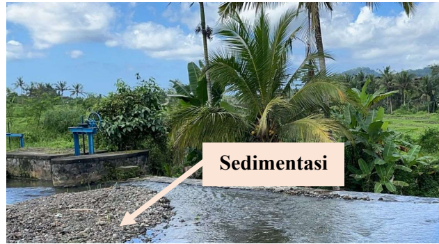
Gambar 6. Penumpukan sedimen pada Bendung Gantalan
